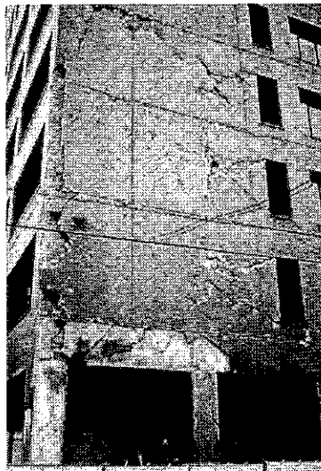
▲剥落したタイルと外壁の亀裂
