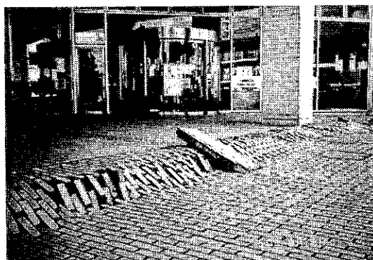
図書館前の道路が陥没して壊れた舗装▲
