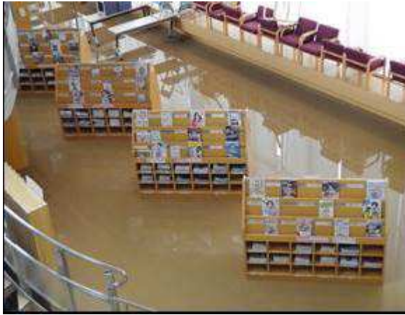
1階閲覧室 床上浸水 10 cm 大洲市立図書館
