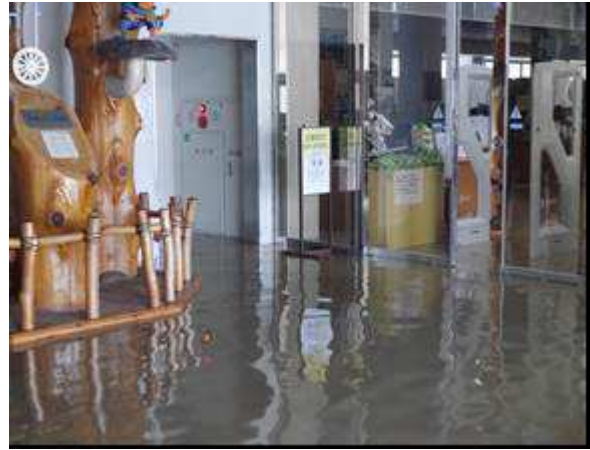
1階正面玄関ホール 床上浸水 10 cm
