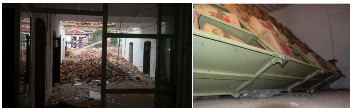
地震で被災したマダン図書館1階と倒壊書架
