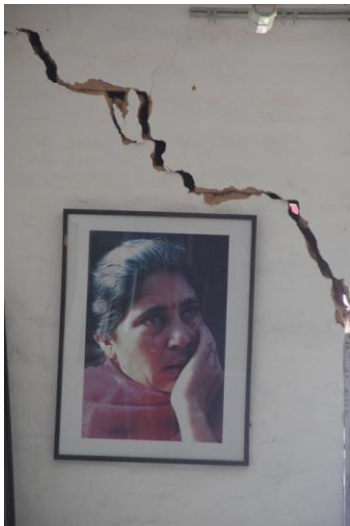
ひび割れした展示室
